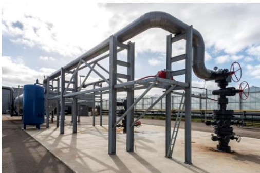
Geothermie installatie (links) en aquathermie (rechts)
